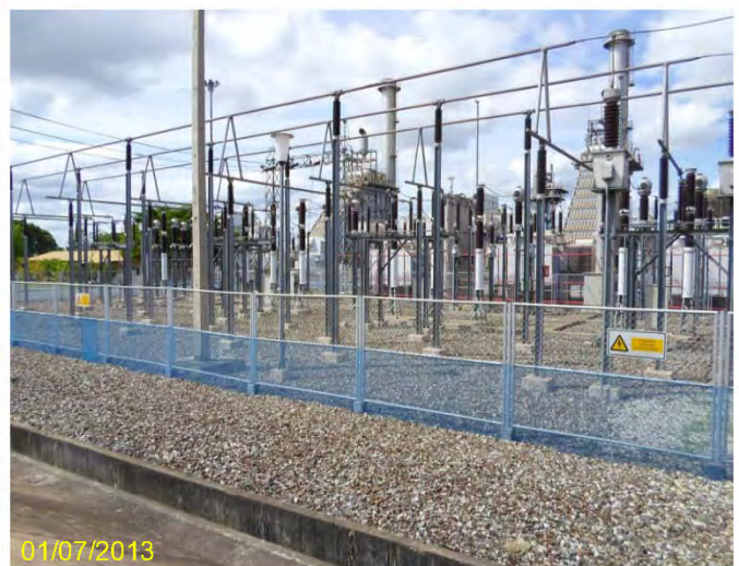
สถานีจ่ายไฟฟ้า
