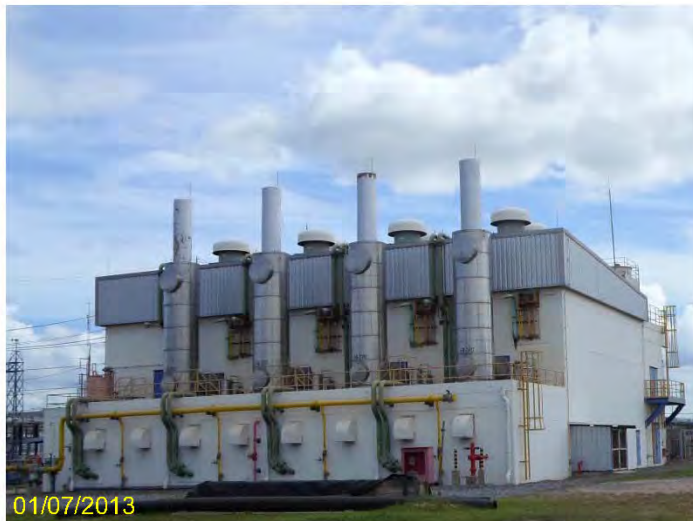
พื้นที่ส่วนการผลิตไฟฟ้าแบบเครื่องยนต์ก๊าซ ชุดที่ 1-4
