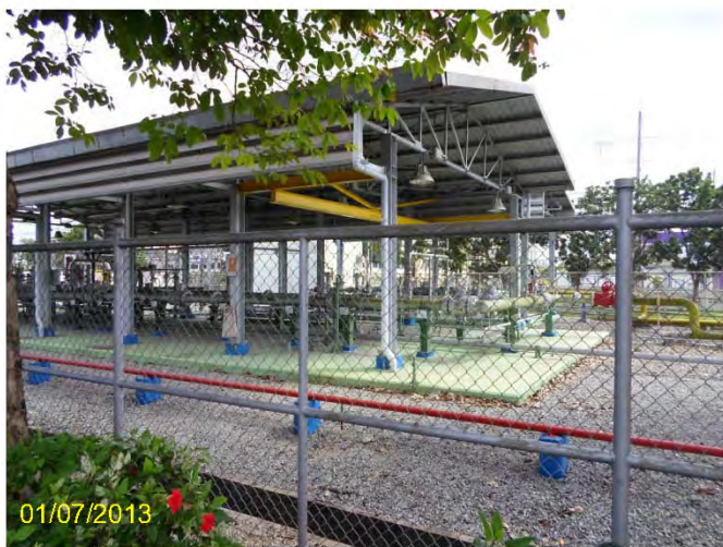
สถานีควบคุมความดันและวัดปริมาณก๊าซ (Metering and Regulation Station : MRS)
