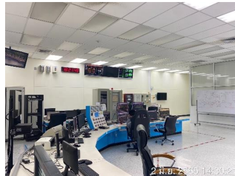
ภาพที่ 2-5 Control Room
